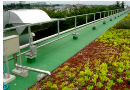
排気口からの熱風による衰退事例
